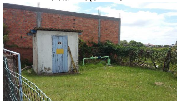
Figura 4-4 - Manancial de captação de água bruta – Poço TAV-02
