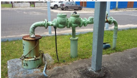
Figura 4-3 - Manancial de captação de água bruta – Poço TAV-03
