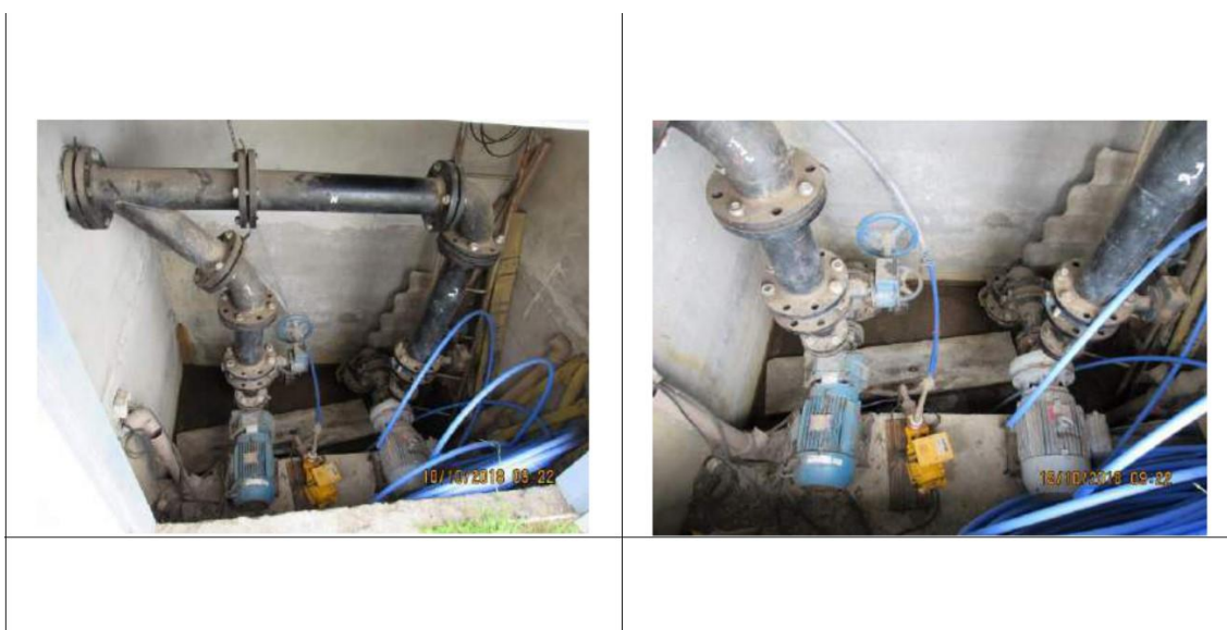
Figura 4-11 - Bombas de recalque para rede e reservatório elevado
