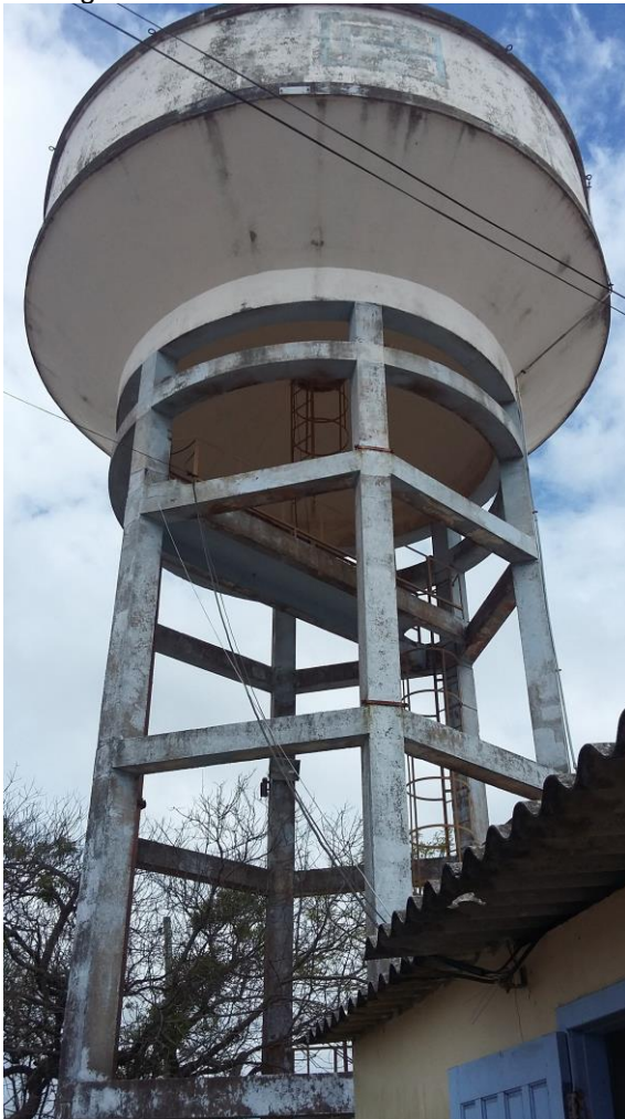
Figura 4-12 - Reservatório R1 - 100 m 3
