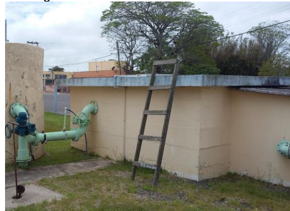
Figura 4-13 - Reservatório R2 - 14 m 3
