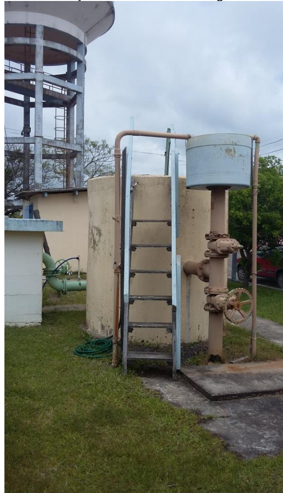
Figura 4-10 – Filtro para precipitação de ferro - Estação de Tratamento de Água
