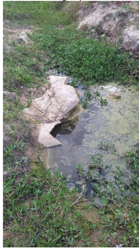
Figura 7-3 – Acúmulo de água em valo para drenagem pluvial
