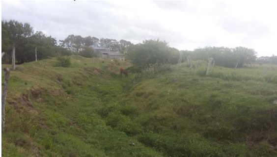
Figura 7-6 – Canal no final da Rua Santo Antônio responsável por escoar a água pluvial captada no sistema de microdrenagem implantado na área central
