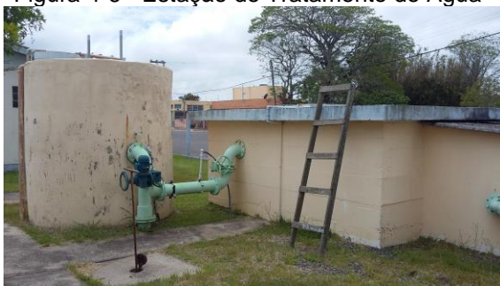
Figura 4-6 - Estação de Tratamento de Água
