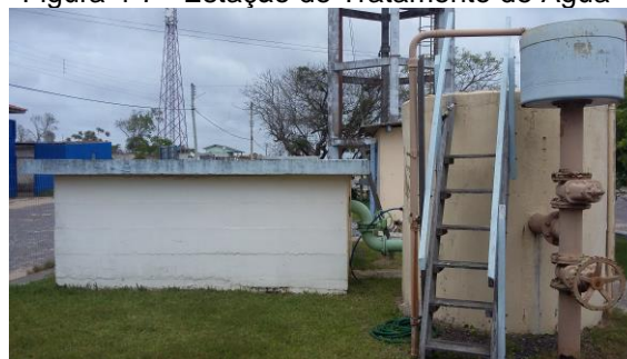
Figura 4-7 - Estação de Tratamento de Água
